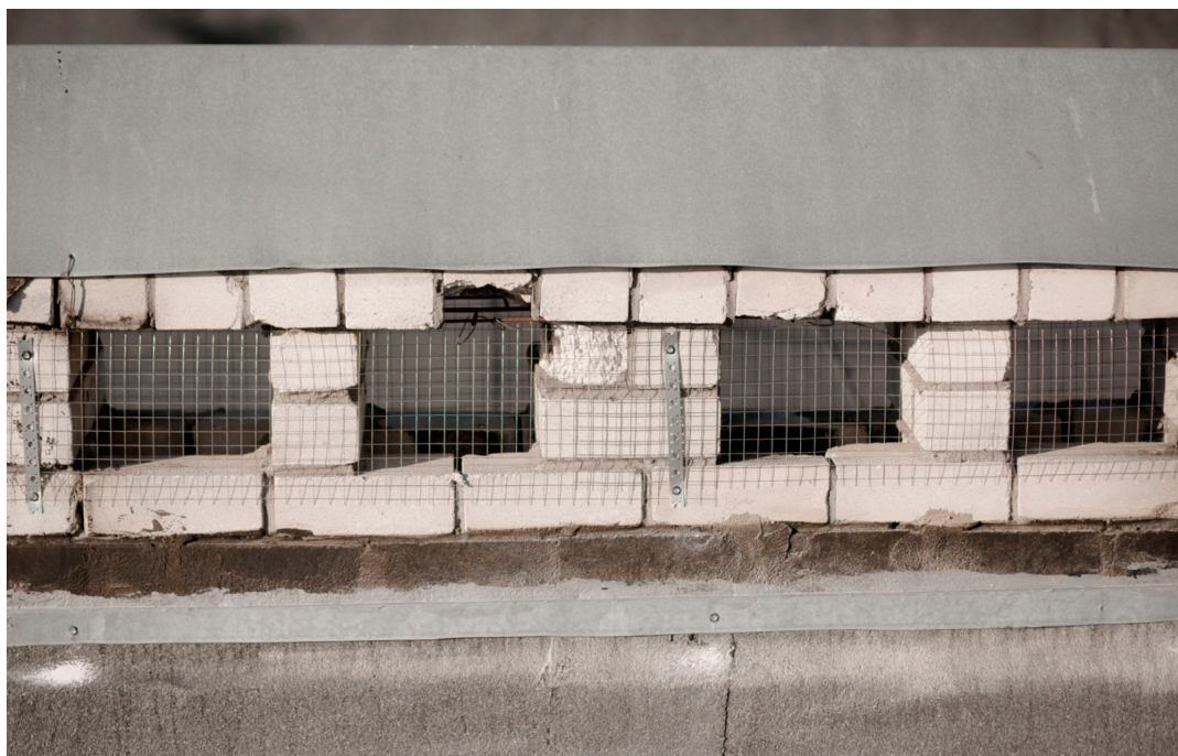
Рис. 7. Установленный металлический отлив на кирпичной стене. Поверхность кирпичной кладки предварительно оштукатурена и грунтована битумным праймером
