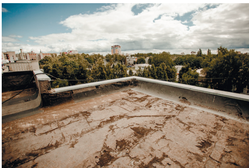
Рис. 1. Общее состояние кровли через 30 лет эксплуатации
