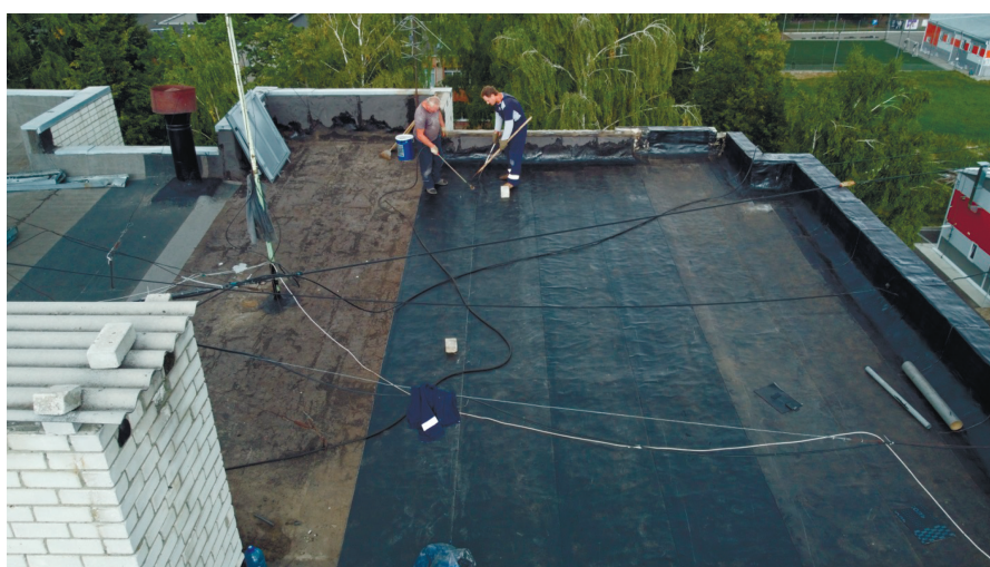
Рис. 4. Укладка первого слоя кровельных материалов с механическим креплением. Последовательность укладки от верхних участков в направлении к водоприемной воронке. Производится спайка швов нахлеста материалов. Часть парапетов уже оклеена
