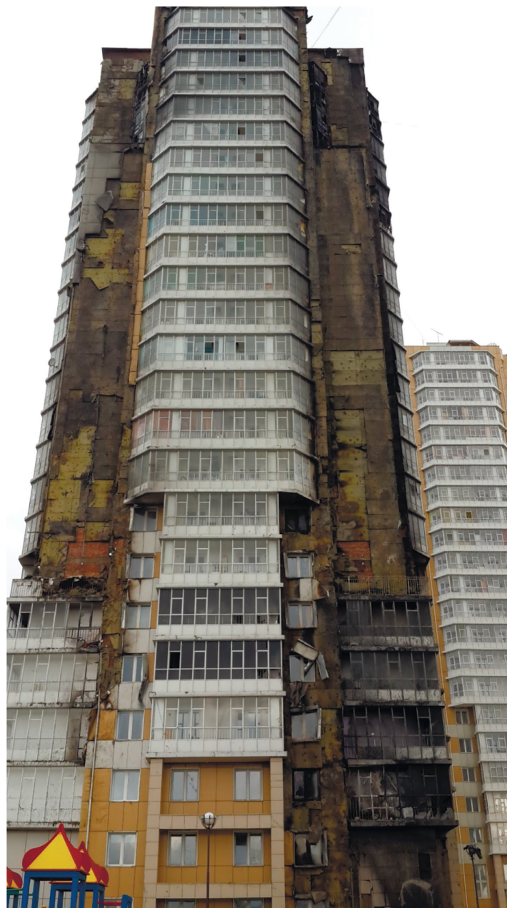
Рис. 5. Последствия пожара на вентилируемом фасаде
