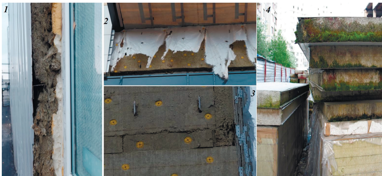
Рис. 4. Дефекты утеплителя: 1, 3 – потеря структуры материала; 2 – обрывы ветровлагозащитной мембраны; 4 – образование мха и черной плесени в долгоскладируемом материале
