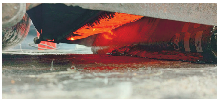
Рис. 6. Образование расплава битумной массы под воздействием безогневого нагрева битумсодержащих материалов. Заполнение горячей мастикой всех пустот и неровностей на кровле
